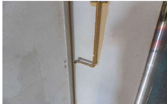
Tubería para gas LP
