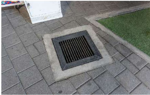
Rejillas para desagüe de los parqueos
