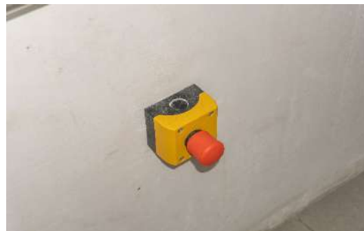
Detalle de botón paro de emergencia
