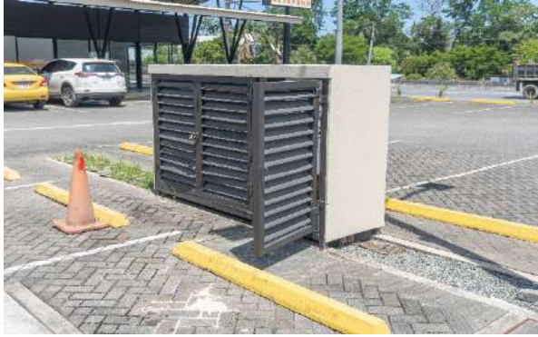
Espacio de almacenamiento para equipos de planta de tratamiento
