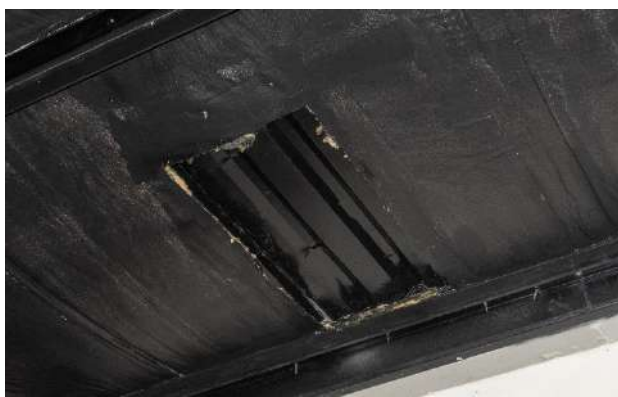
Detalle de daño en cielo raso
