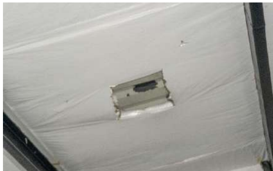
Detalle de daño en cielo raso
