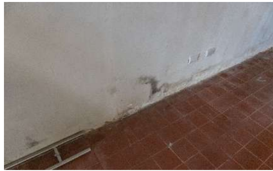
Detalle de daños por humedad
