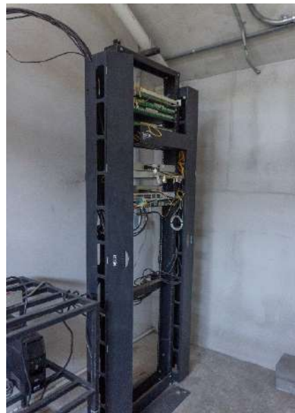
Rack para servidores y redes
