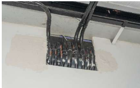
Tubería para distribución de cables
