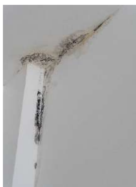
Deterioro en paredes cerca de los sanitarios
