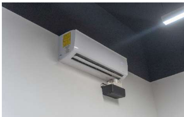
Aire acondicionado en área de almacenamiento
