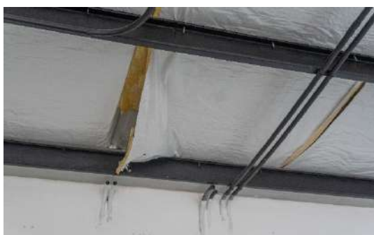
Daños en el aislante
