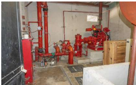
Cuarto de Máquinas
