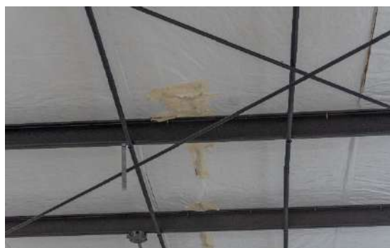
Detalle de daños en el aislante del cielo raso local FF9
