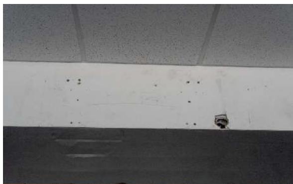
Daños en paredes local FF11
