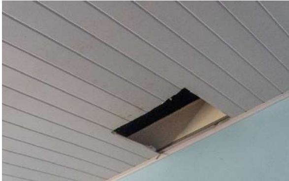
Cielo raso y detalle de daños (Área 2)
