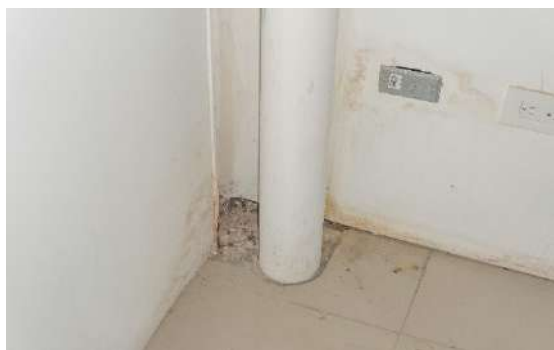
Daño por humedad en base de tubería
