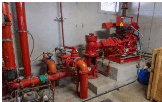
Bomba de agua principal
