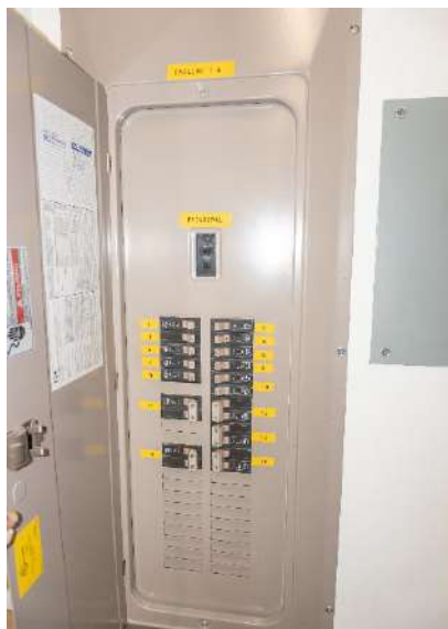
Centro de carga
