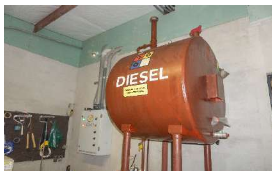
Tanque de almacenamiento de Diesel
