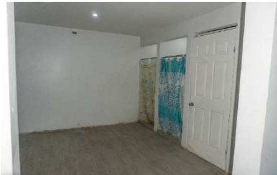
Duchas y sanitarios sector oeste local FF8
