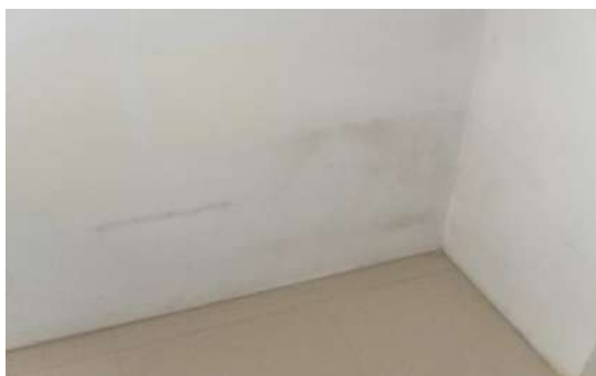
Manchas de humedad en paredes
