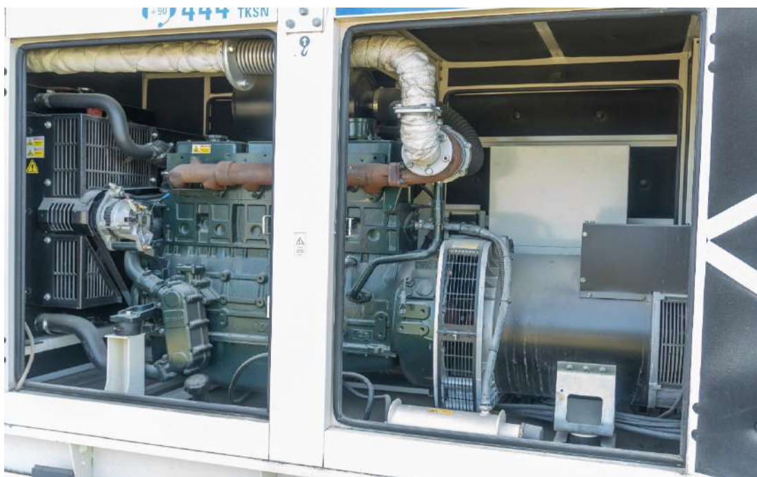
Vista interna de uno de los generadores (Generador 1, el que está contiguo al parqueo),
