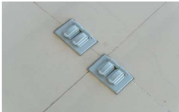
Contectores eléctricos protegidos (Instalados en el suelo y funcionando)
