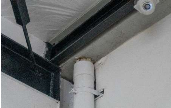
Detalle de daños en tubería de agua pluvial
