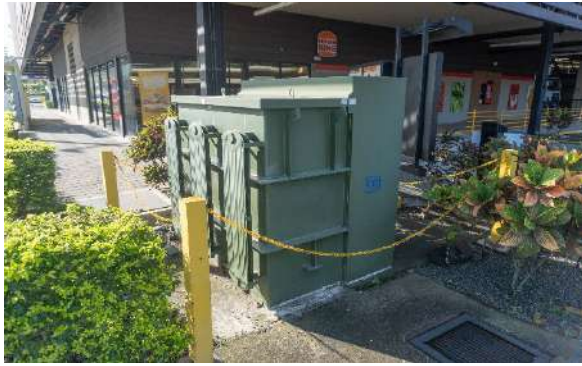
Transformador eléctrico de tipo pedestal (Tiene una calcomanía del ICE)
