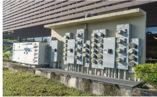
Cantidad de medidores eléctricos junto a un generador eléctrico
