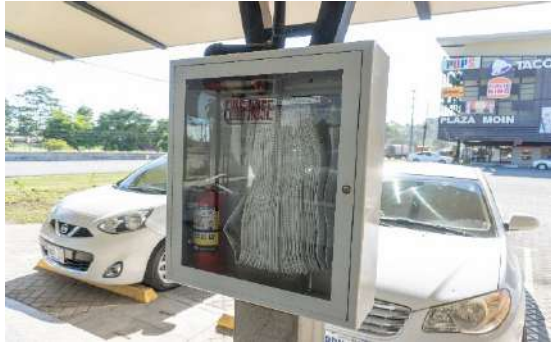
Kit de extintor y mangueras contra incendios, ubicado entre los locales FF-2 y FF-3 en el pasillo
