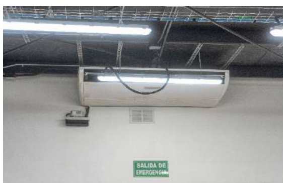
Aire acondicionado local FF4
