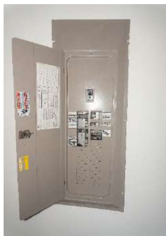
Centro de carga
