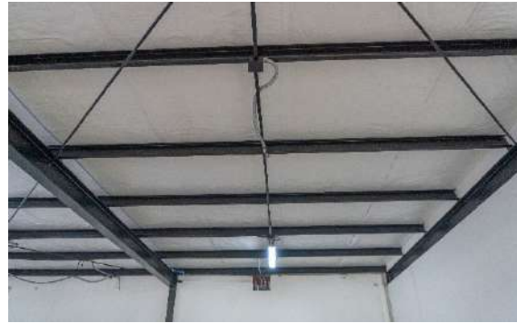
Cielo Raso (Derecha)
