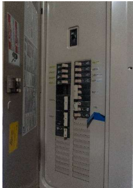
Centro de carga 2 de 2 en cuarto de vigilancia
