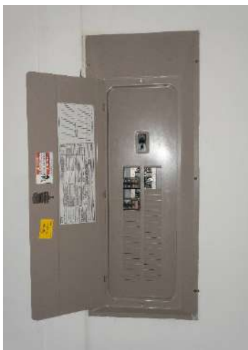
Centro de carga
