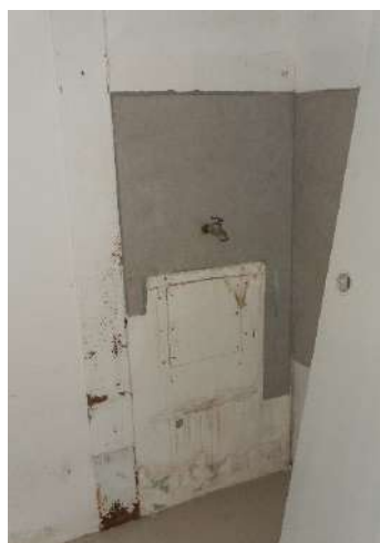
Paredes con óxido y sin acabado
