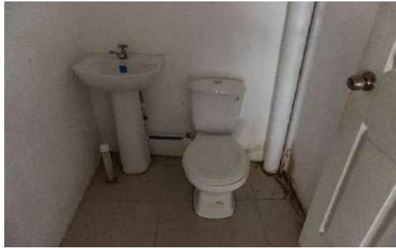
Sanitarios local FF7
