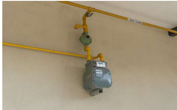
Tubería de Gas LP con su respectivo medidor (Ubicada arriba de la prevista para bomberos)
