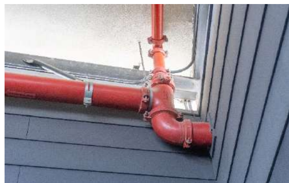
Tubería de agua hacia locales
