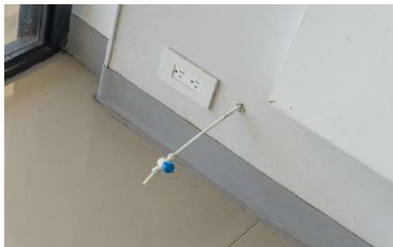
Prevista cerca de conector eléctrico
