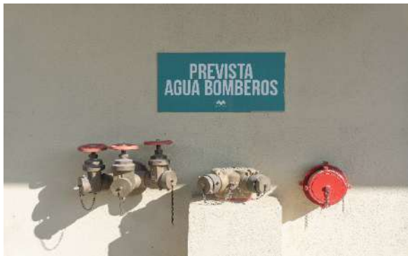
Detalle de prevista para conectar mangueras de bomberos, ubicada contiguo al generador auxiliar eléctrico dos.
