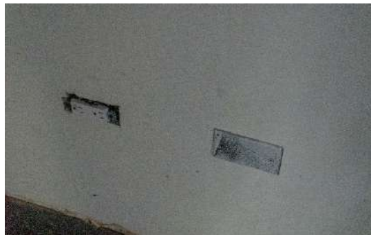
Detalle de daños en conectores eléctricos
