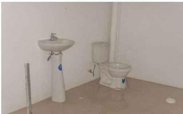
Sanitario y lavatorio en local FF5
