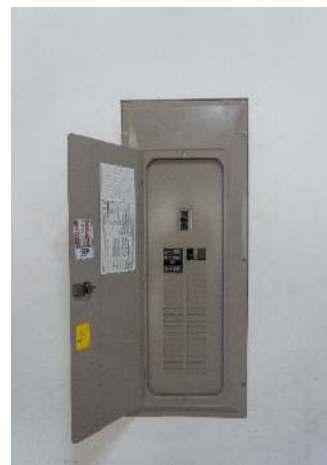
Centro de carga
