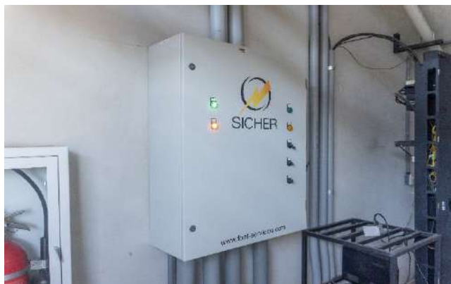
Panel de control eléctrico
