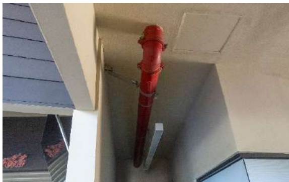
Tubería de agua hacia cuarto de máquinas
