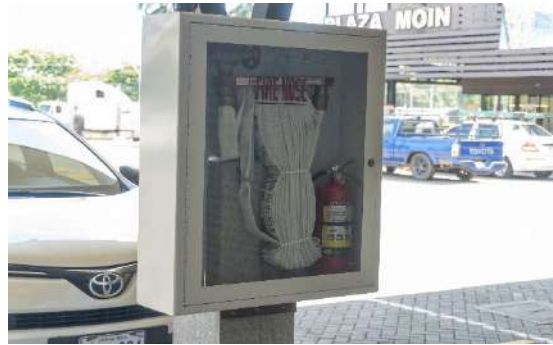
Kit de extintor y mangueras contra incendios, ubicado entre los locales FF-11 y FF-12 en el pasillo
