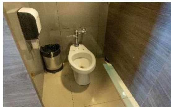
Vista de batería 1_3 en sanitario femenino
