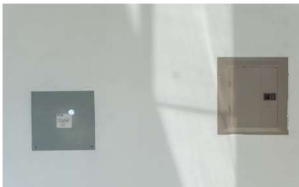
Centros de carga (ubicados al fondo del local)
