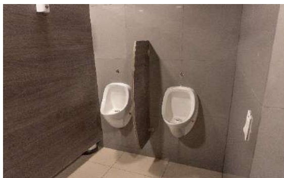
Orinales en Sanitarios Masculinos
