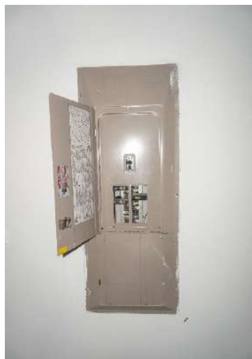
Centro de carga
