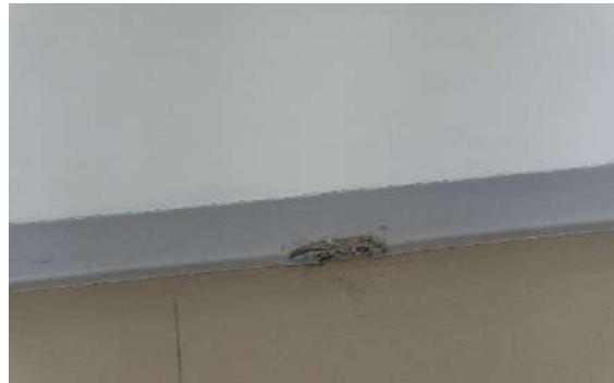
Daño en rodapié y pared
