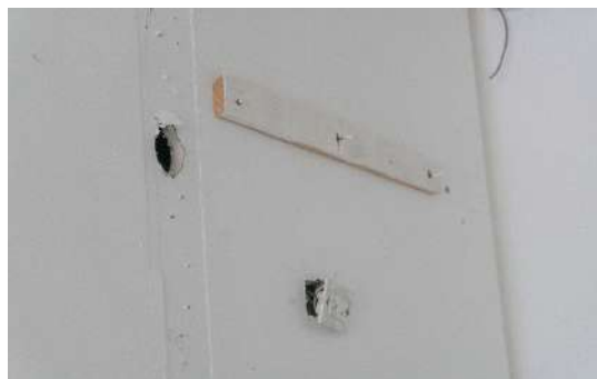
Daños en paredes
