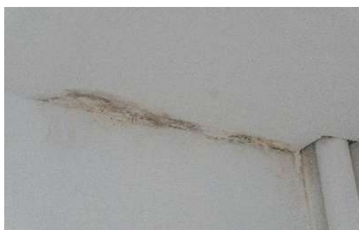
Deterioro en Paredes dentro de sanitarios
