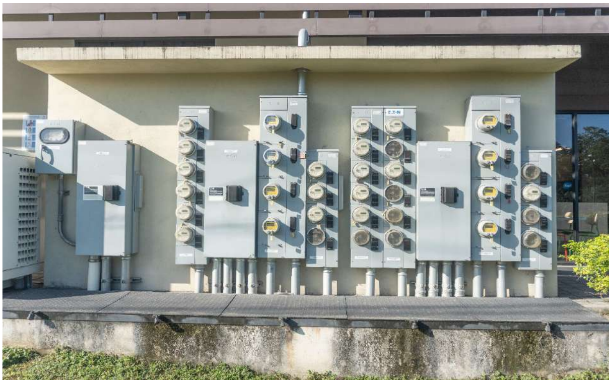
Vista frontal de medidores eléctricos
