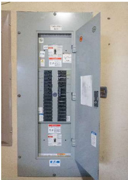
Centro de carga 1 de 2 en cuarto de vigilancia
