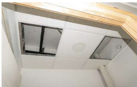
Daños en cielo raso local FF11
