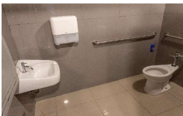
Batería sanitaria 2_2 para Ley 7600 en sanitarios masculinos
