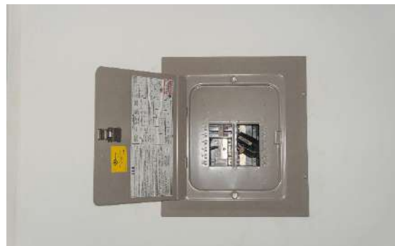
Centro de Carga
