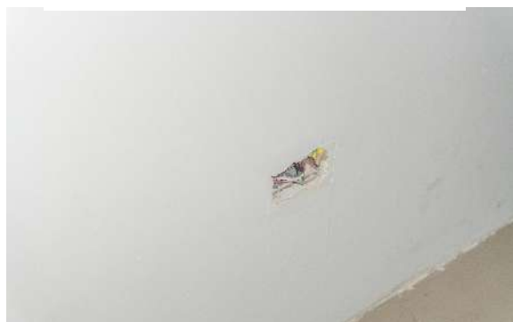
Conectores eléctricos dañados
