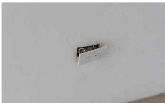
Daño en conector eléctrico local FF9
