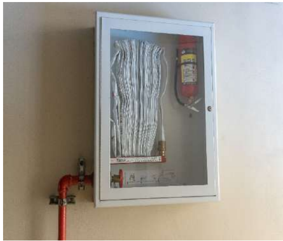
Kit de extintor y mangueras contra incendios, ubicado entre los sanitarios públicos
