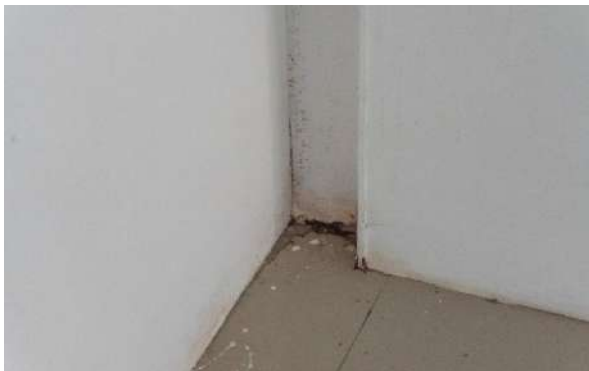
Daño por humedad en paredes y pisos
