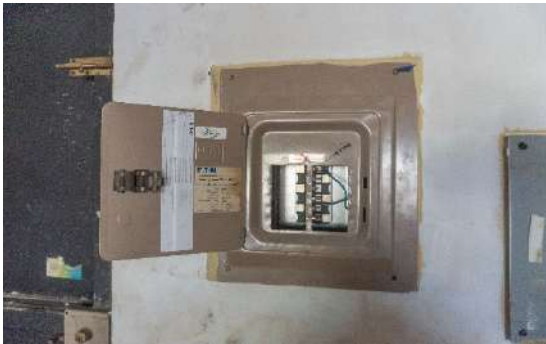
Centro de carga
