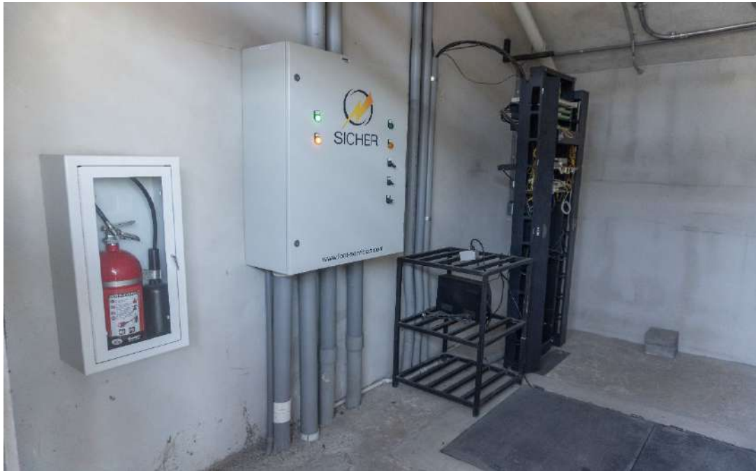
Vista general de cuarto de datos
