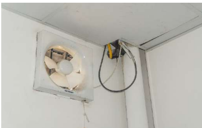
Extractor y cables que salen por el cielo raso
