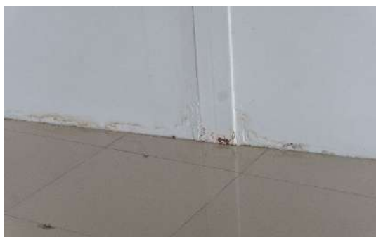
Daños en las paredes por humedad
