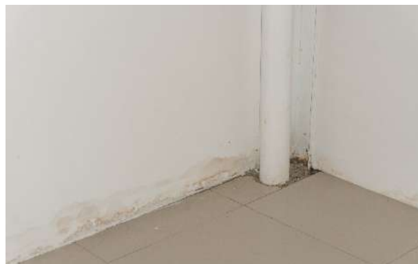
Detalle de humedad en pared y tubería de agua pluvial
