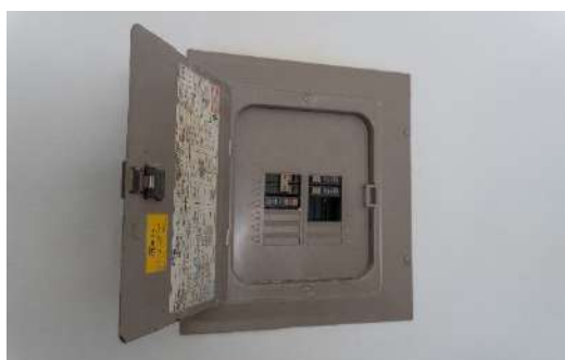
Centros de carga (Abierto)
