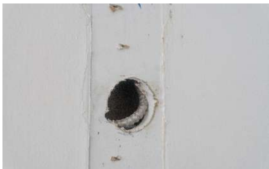
Daños en paredes
