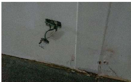
Detalle de daños en conectores eléctricos
