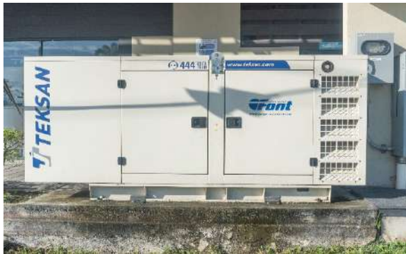
Vista frontal del generador auxiliar uno (de dos generadores eléctricos auxiliares) Ubicado frente a la carretera, dentro de las instalaciones al costado oeste del parqueo contiguo a los medidores eléctricos
