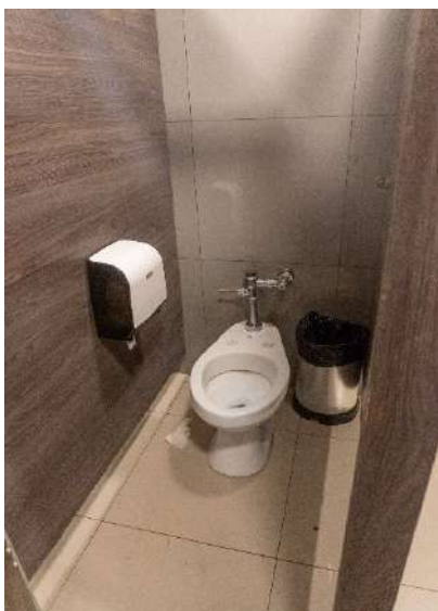
Batería sanitaria 1_2 en sanitarios masculinos
