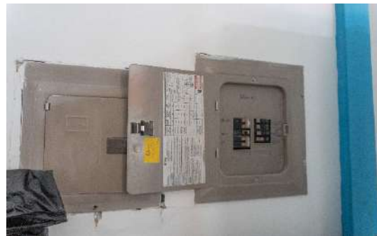
Centro de carga
