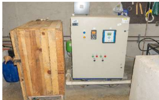
Panel de control de bombas
