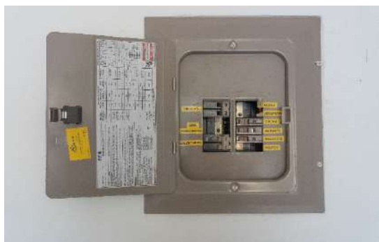
Centro de Carga
