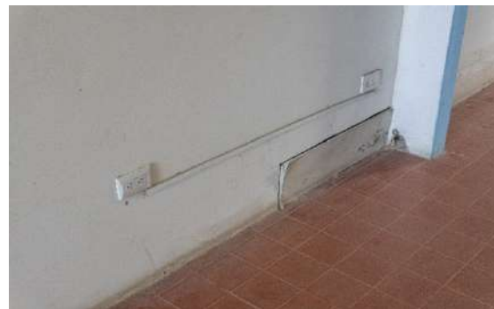
Detalle de daños en paredes
