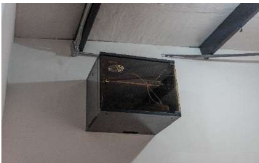
Caja tipo Rack para switchers y redes
