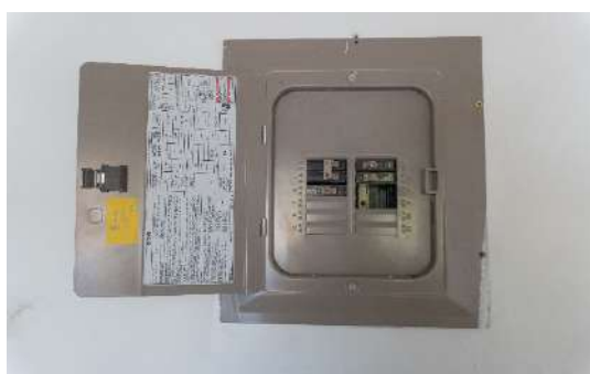
Centro de carga
