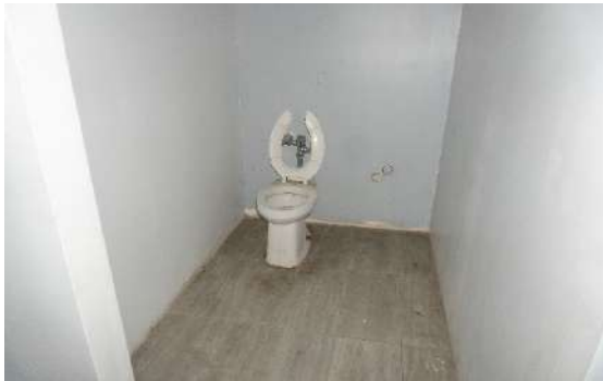
Sanitario Principal local FF8
