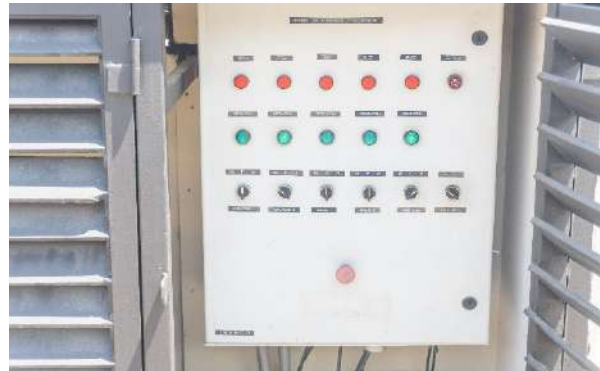
Panel de control de planta de tratamiento
