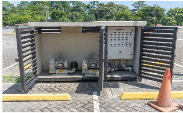
Bombas y panel para planta de tratamiento (Ubicado en el parqueo)
