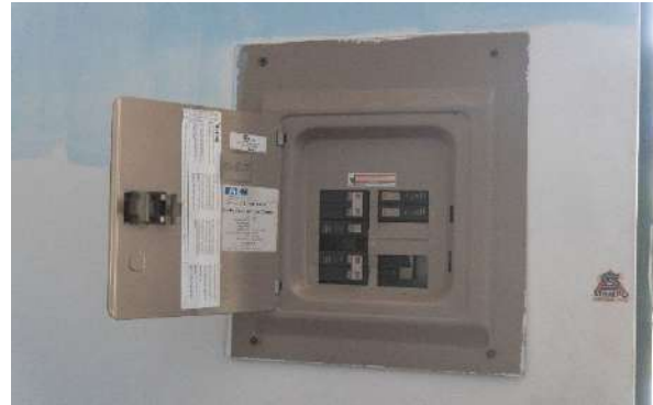
Centro de carga
