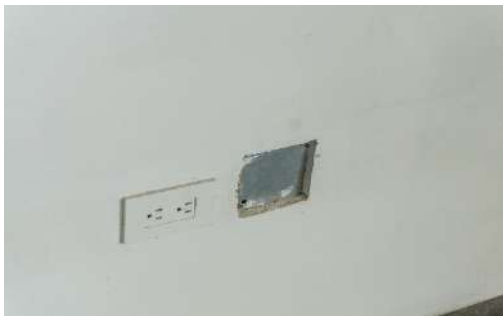
Detalle de daño cerca de conector eléctrico
