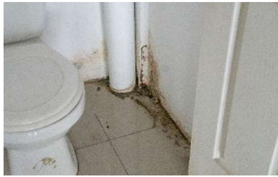
Deterioro en sanitarios local FF7
