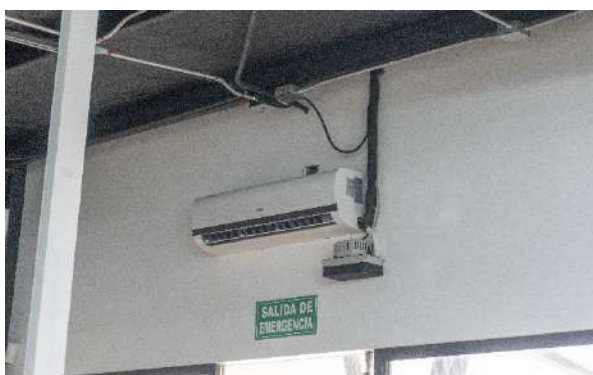
Aire acondicionado local FF3
