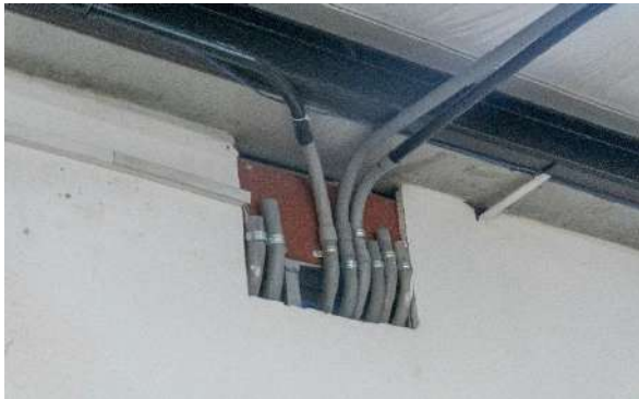
Tuberías para distribución de
