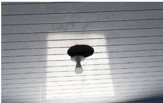
Cielo raso y detalle de estado de luminarias (Área 2)
