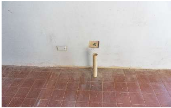
Prevista para tubería de agua
