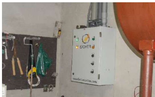
Panel de control electromecánico
